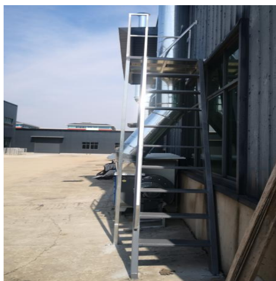
DA002排气筒监测平台
