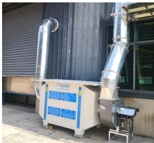
固化废气活性炭装置
